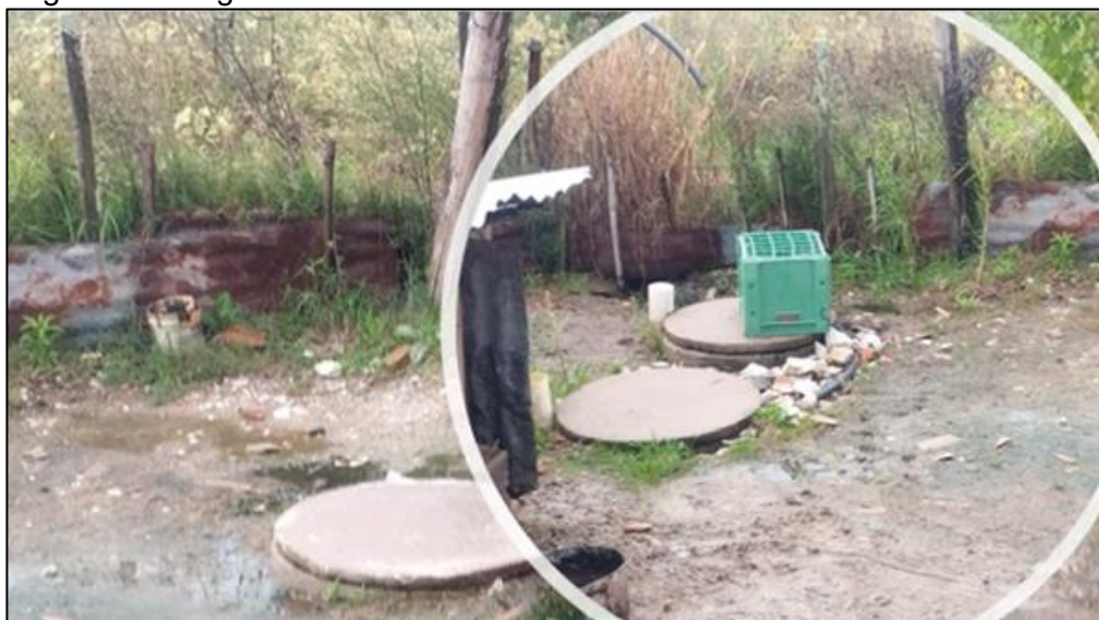
Figura 12 - Esgoto a céu aberto.
