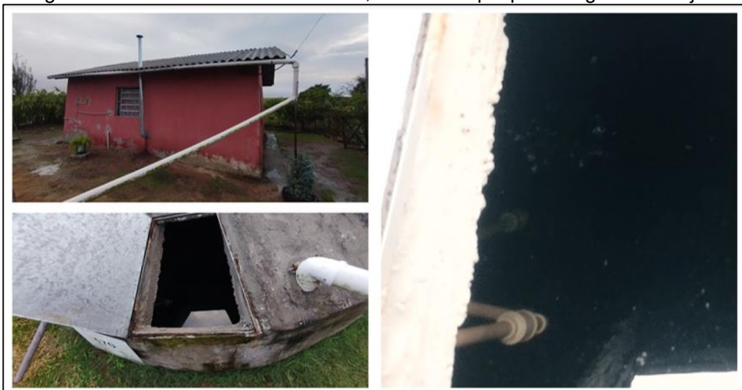
Figura 13 - Cisternas das residências, com destaque para a água com sujeira.
